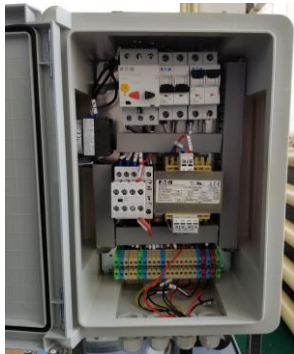
Fig.6: Tablou electric module de pompare.
