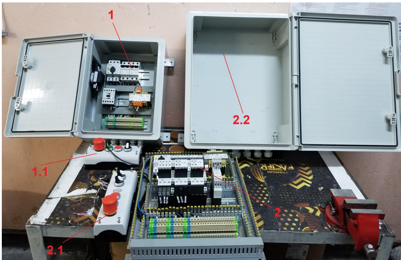
Fig.1: Tablouri electrice pentru sistemele de pompare 1 și 2 (execuție parțială)
